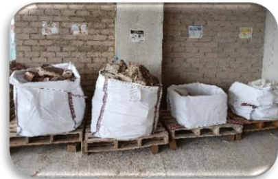
Imagen 5: Segregación en obra
